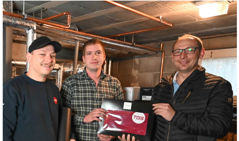
Lucas Brunner aus Höchst nutzt mit der Stückholzanlage von TGS sein eigenes Holz und produziert selbst Strom über die PV-Anlage.
